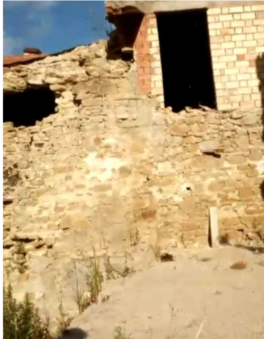
Rudere a Piedilama dopo 4 commissioni ancora non si riusciva a demolire
